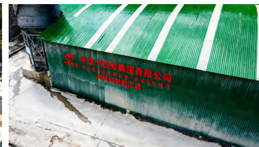
中铁十四局·宜涪高铁·重庆石柱段
